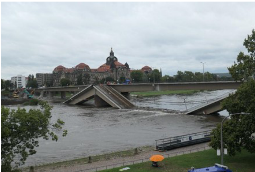
Puente Carola, Dresden, desplome el 11 de septiembre de 2024
